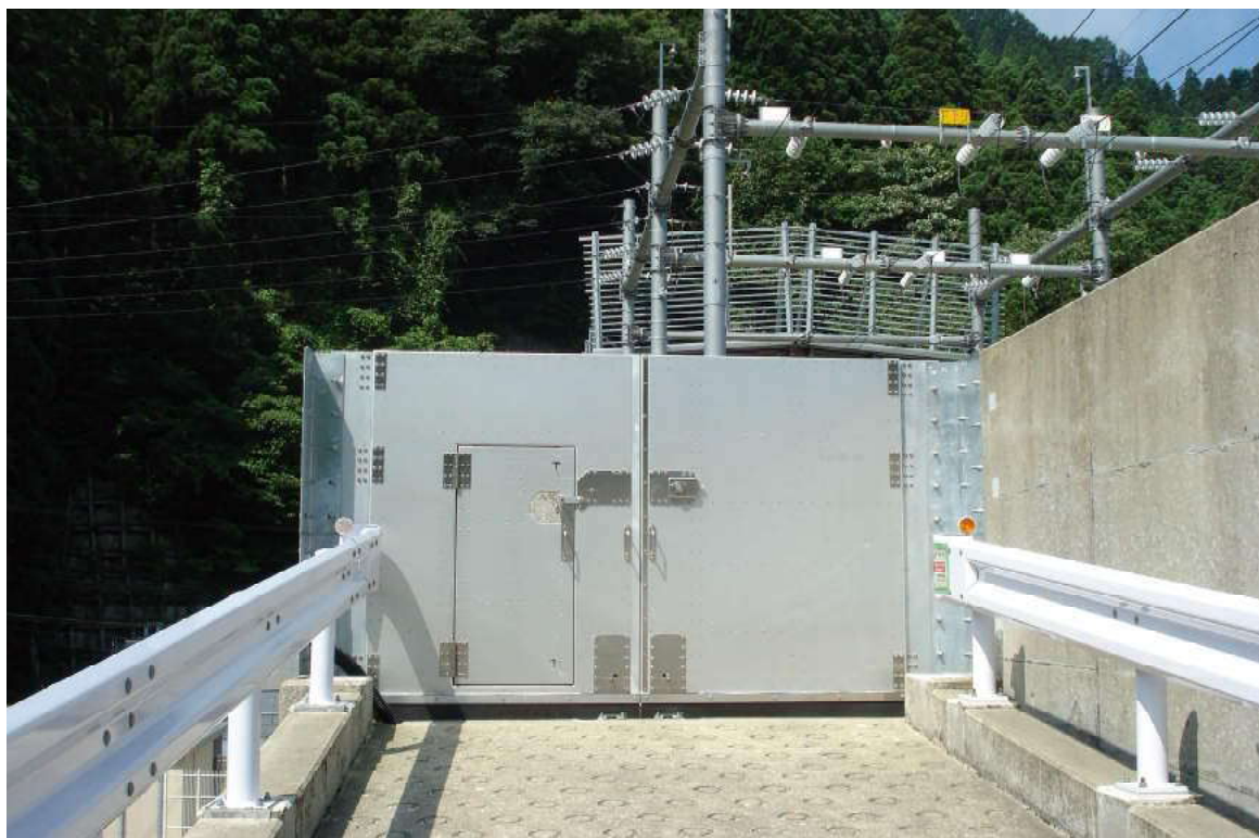
軌道点検扉：支柱 鉄骨 溶融亜鉛メッキ/AL両開門扉
