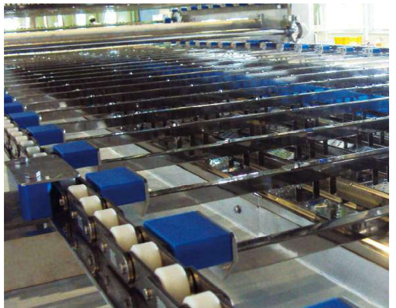
コンベヤー可動部
